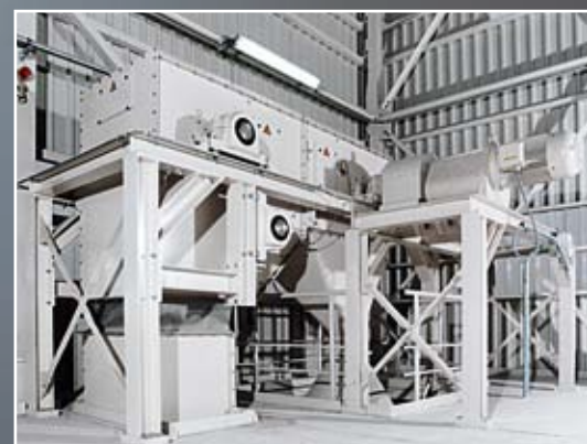
Abgabestation eines WB 640 mit 30 kW-Antrieb
